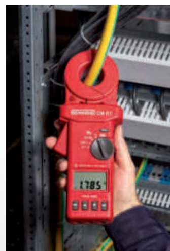
Messung des Betriebserders einer Industrieverteilung
