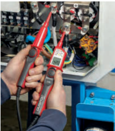
Prüfung der Ausgangsspannung einer DC-Ladeeinrichtung
