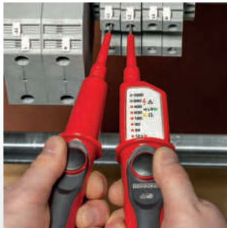
Drehfeldprüfung an den Ausgangsklemmen einer USV
